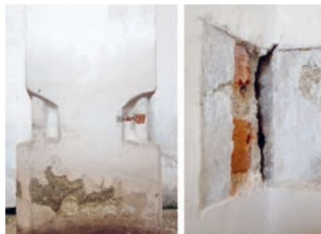
Ohne Verzahnung mit der Außenmauer ausgeführter Wandpfeiler im Kirchenraum mit teils freigelegten gotischen Rundstabprofilen (Fotos: kb-bm)
