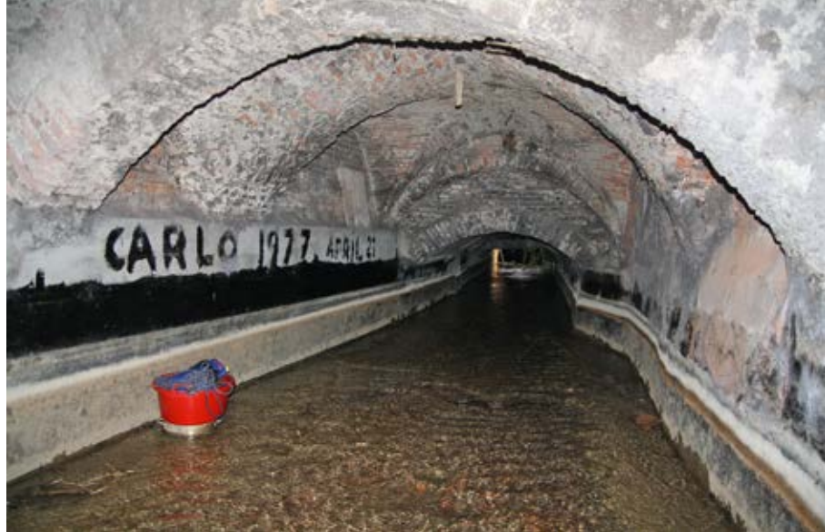
„CARLO 1977, APRIL 21“ hat hier unter dem St.-Jakobs-Stift in Augsburg die Kanalwände mit Bitumen überzogen, das in Teilen wieder abgebrochen ist (Foto: BLfD, Bernhard Häck)
