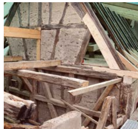
Vom Hausschwamm vollständig zerstört, war das Dachwerk von Gaden 4 nicht mehr zu halten, 2013 (Foto: Peter Hanf, Gemeinde Thüngersheim)
