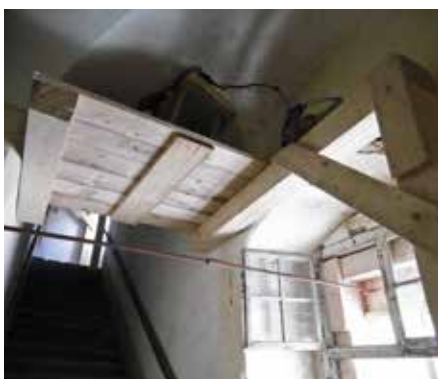
Statische Notsicherung im Ostflügel, 2015
