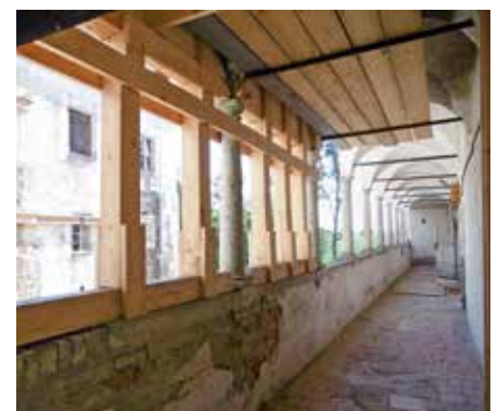
Statische Notsicherung im obersten Arkadengang des Westflügels, 2015
